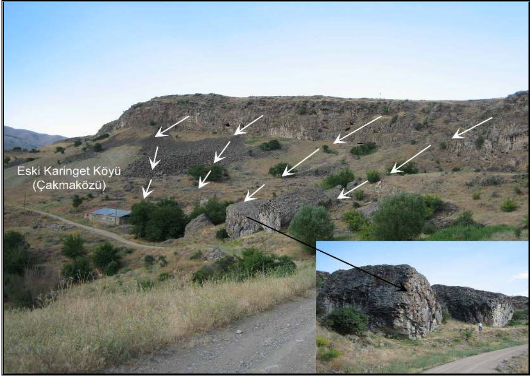
Foto 129: Çakmaközü köyünün eski yerleşim alanı bazalt kornişlerinden kopan kayaların düşmesi nedeniyle terk edilmiştir.
