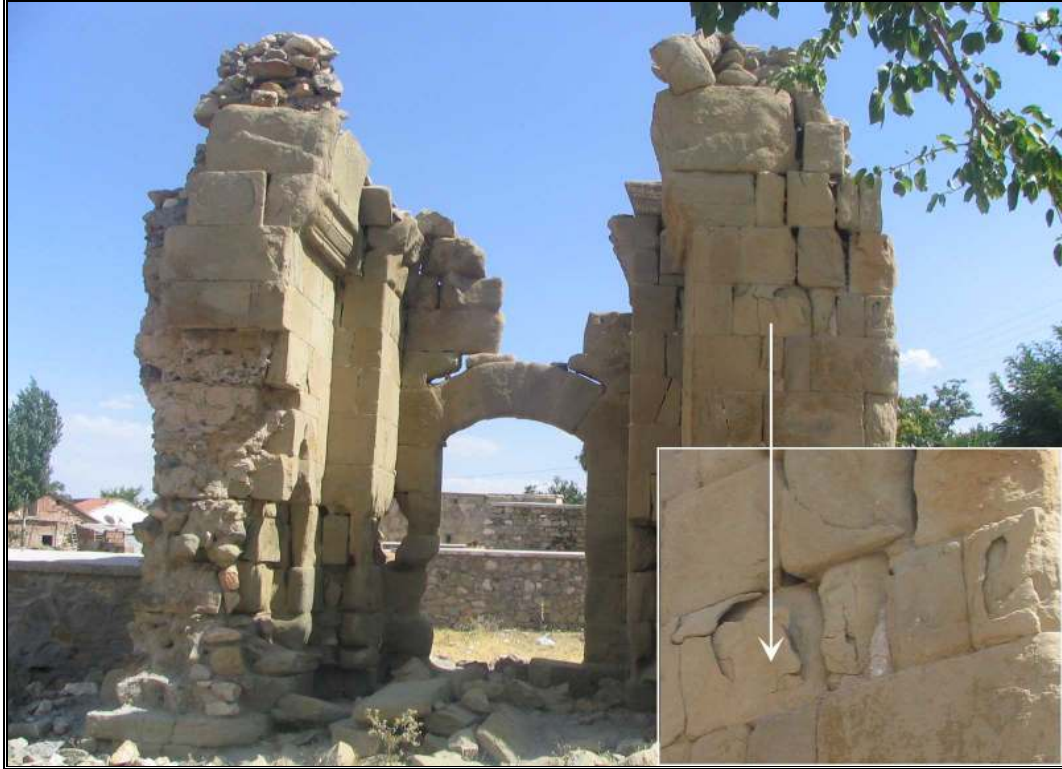
Foto 113: Esiye(Arslaniye) Medresesinin günümüzde ayakta kalabilmiş olan giriş kısmı. Tarihi yapının duvarlarında kullanılan kumtaşı aşınımına uğramıştır.
