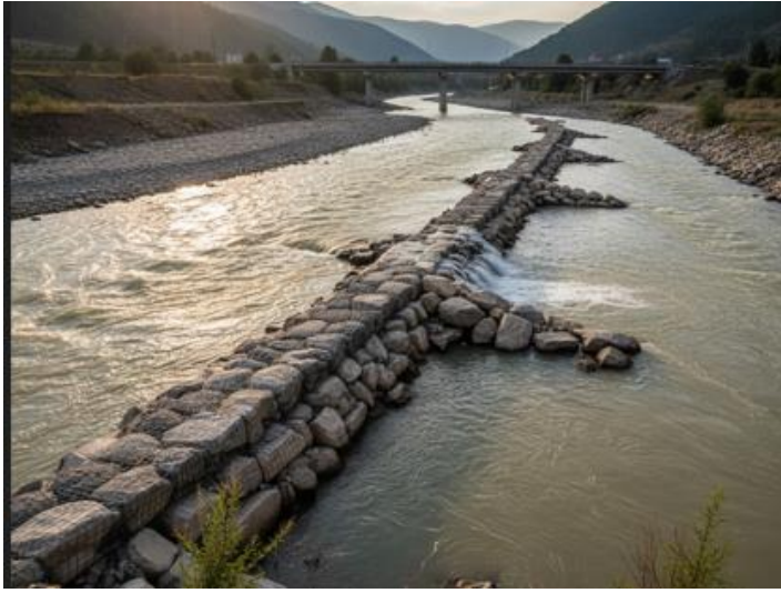
Şekil 16. Akarsu yatağında akımı yönlendirme ve oyulma kontrolü amacıyla kullanılan gabion dolgulu (taş kafes) mahmuz yapısı (OGM, 2013).
