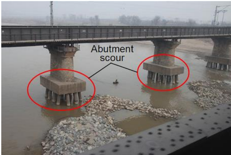
Şekil 1. Meydana gelen şiddetli oyulma vakası sonrası köprü temelinin ve kazıklarının açığa çıkmış görünümü (Xie vd., 2019).
