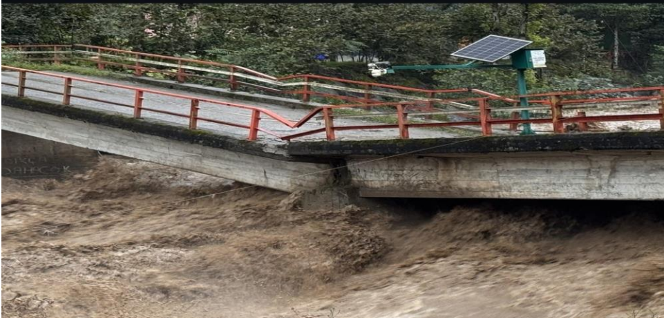
Şekil 4. Rize’de 2025 yılındaki taşkın sonrası hasar gören bir köprü kesiti. (GZT Dijital Haber, 2025)
