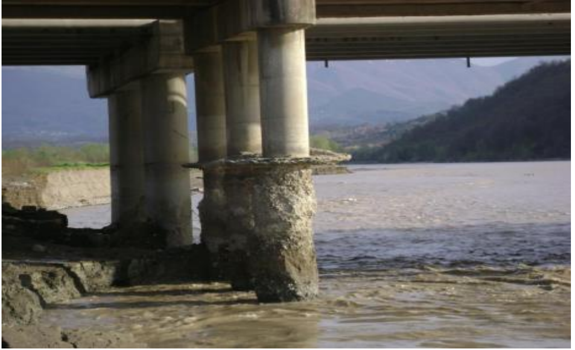
Şekil 3. Filyos II Köprüsü orta ayaklarının tabandaki oyulma sonrası durumu
