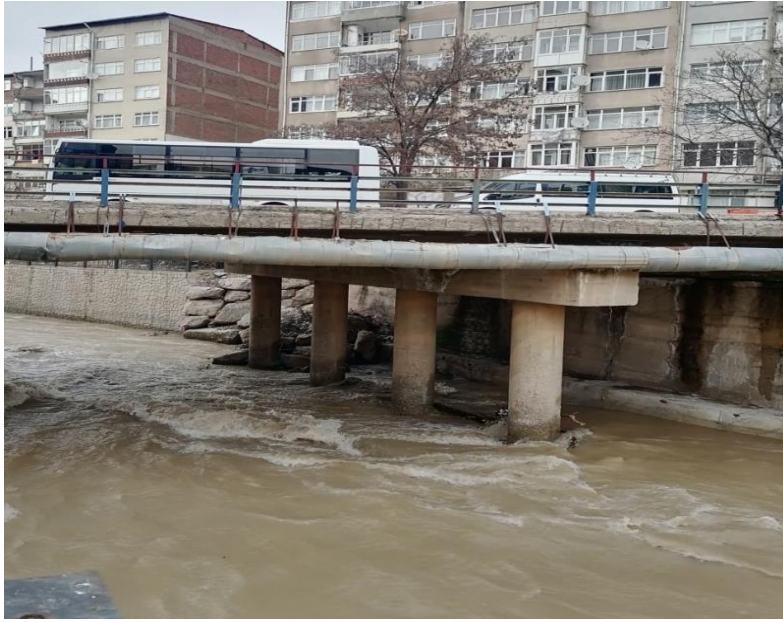
Şekil 15. Harşit Çayı üzerinde yer alan dairesel/silindirik burunlu ayak tipi köprü ayağı örneği, Gümüşhane Merkez, 15 Şubat Caddesi Köprüsü
