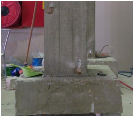
a) Temel pabucunda oluşan çatlaklar
