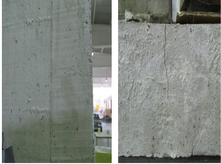
a) Kolonda oluřan atlaklar
