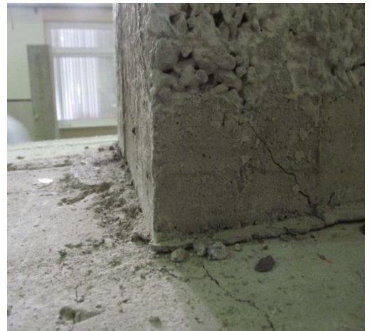
b) Kolon-temel pabucu birleşimindeki çatlaklar
