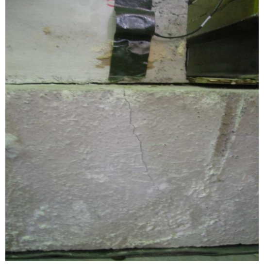
b) Kolon-temel pabucu birleşimindeki çatlaklar
