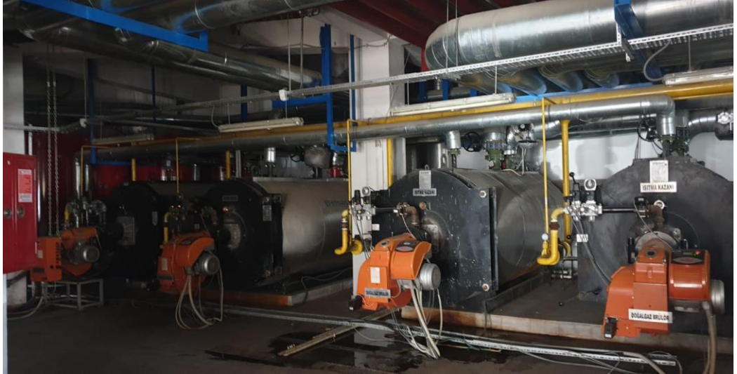
Şekil 2.7. Kazan Dairesinde Bulunan Doğalgaz Isıtıcılar
