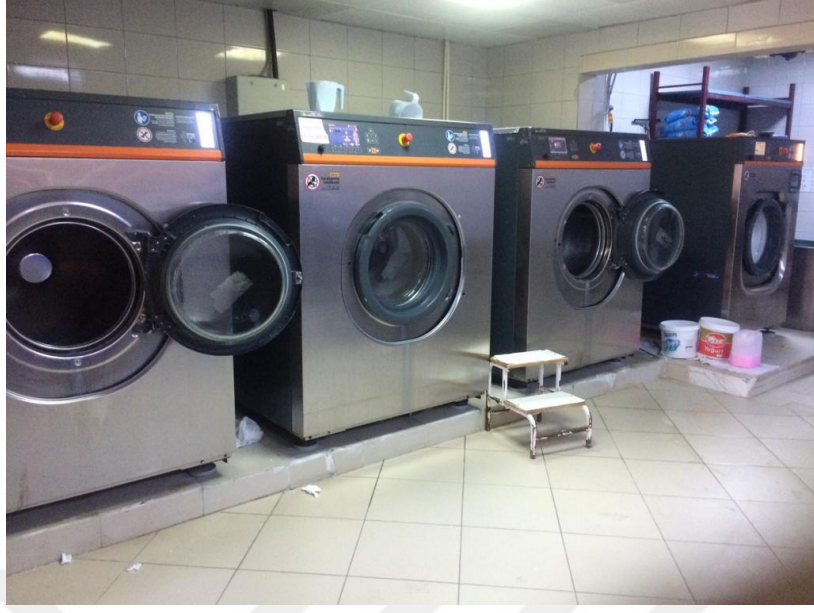
Şekil 2.6. Çamaşırhaneye Ait Yıkama Makineleri
