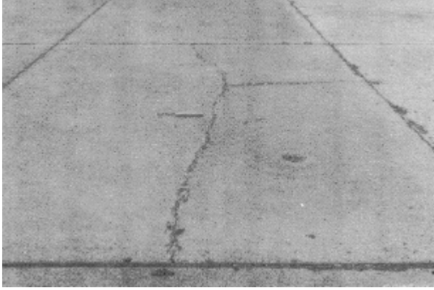
Resim 2.17. Yüksek hasar seviyesinde boyuna çatlak (Durum 2) [19]
