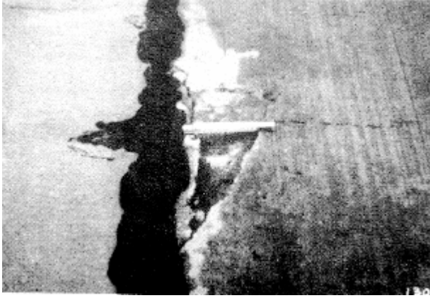
Resim 2.55. Orta hasar seviyesinde derz kopması (Durum 1) [20]
