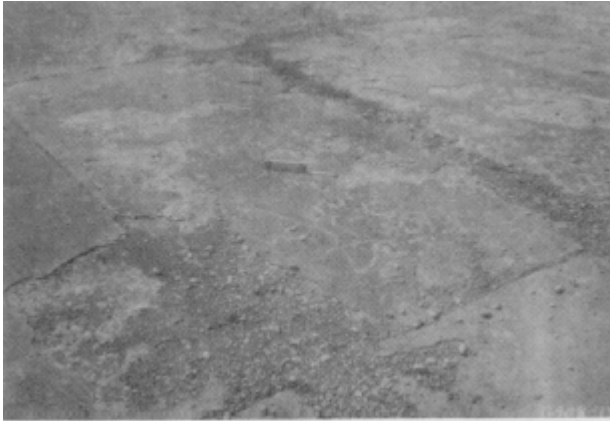
Resim 2.43. Yüksek hasar seviyesinde soyulma [20]
