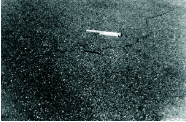
Resim 3.19. Düşük hasar seviyesinde boyuna çatlak [23]
