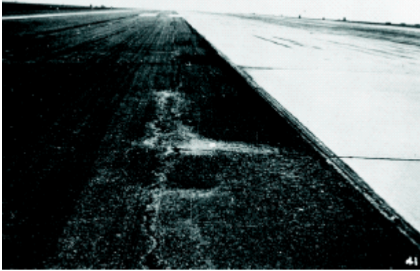
Resim 3.43. Düşük hasar seviyesinde (uçta) ve orta hasar seviyesinde (ortada) sıkışma [23]
