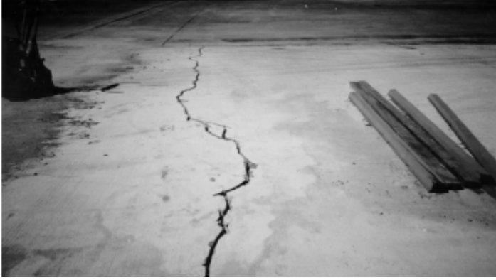
Resim 5.11. Henüz genişletilmiş ve düzeltilmiş bir çatlak [41]
