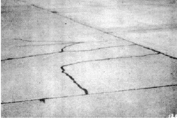
Resim 2.49. Düşük hasar seviyeli kesişen çatlaklar [20]
