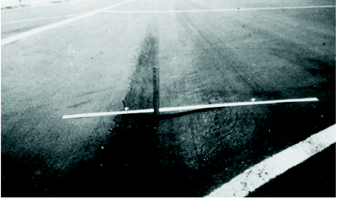
Resim 3.42. Yüksek hasar seviyesinde tekerlek izi [23]
