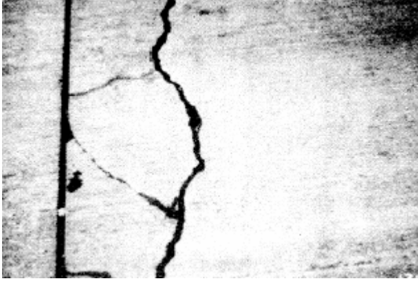
Resim 2.56. Orta hasar seviyesinde derz kopması (Durum 2) [20]
