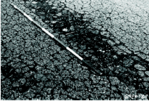
Resim 3.3. Yüksek hasar seviyesinde timsah sırtı çatlaklar [20]
