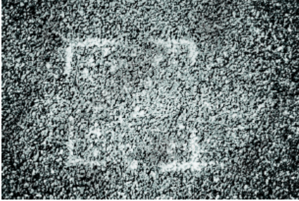
Resim 3.36. Orta hasar seviyesinde çözülme olmuş gözenekli asfalt tabakası (Alanın %25'inden daha az altı agrega kümesi ayrılmış) [23]
