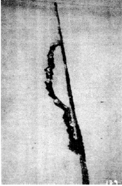
Resim 2.54. Düşük hasar seviyesinde derz kopması (Durum 2) [20]
