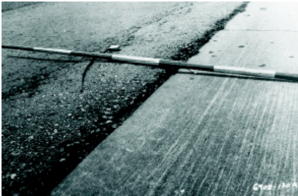
Resim 3.44. Yüksek hasar seviyesinde sıkışma [20]
