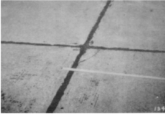
Resim 2.59. Düşük hasar seviyesinde köşe kopması (Durum 1) [20]
