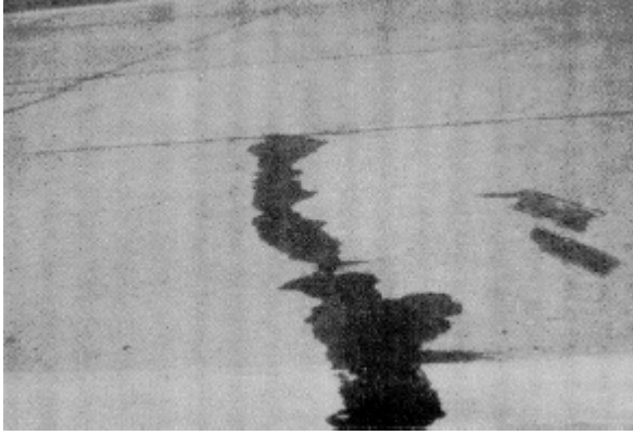
Resim 2.14. Orta hasar seviyesinde enine çatlak (Durum 2) [19]
