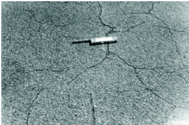
Resim 3.5. Düşük hasar seviyesinde blok kırılması [23]
