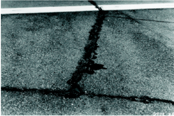
Resim 3.18. Yüksek hasar seviyesinde derz yansıma çatlağı [23]
