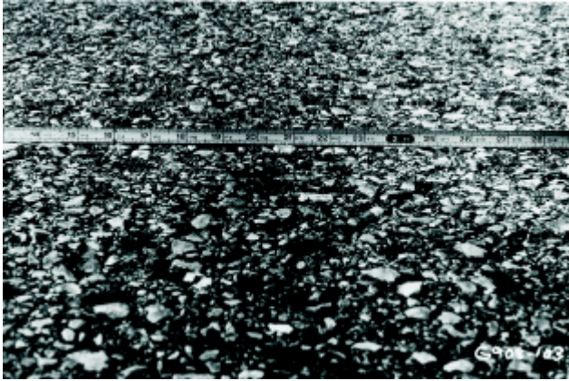
Resim 3.35. Orta hasar seviyesinde çözülme [20]
