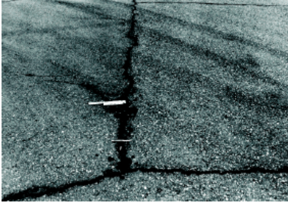
Resim 3.17. Orta hasar seviyesinde derz yansıma çatlağı [23]
