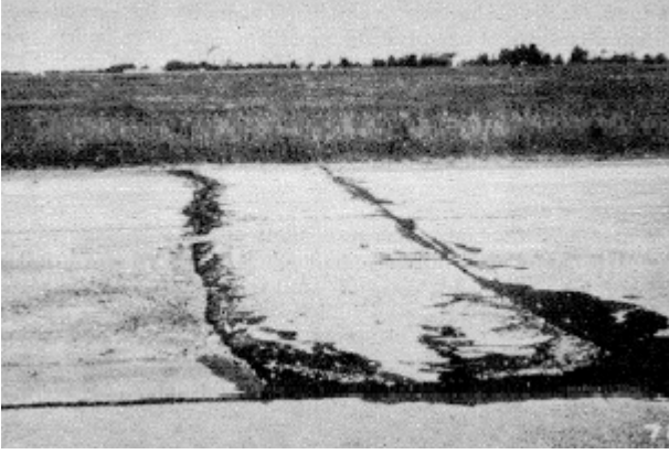
Resim 2.2. Orta hasar seviyesinde kabarma [20]
