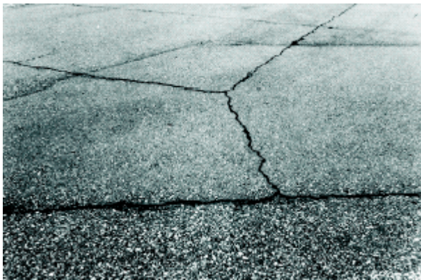
Resim 3.15. Düşük hasar seviyesinde derz yansıma çatlağı [23]
