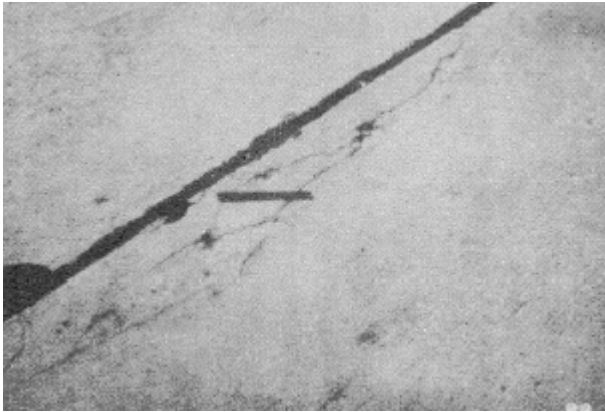
Resim 2.20. Orta hasar seviyesinde D çatlağı (Durum 2) [20]
