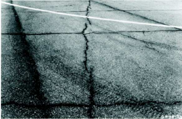
Resim 3.16. Orta hasar seviyesinde derz yansıma çatlağı [23]
