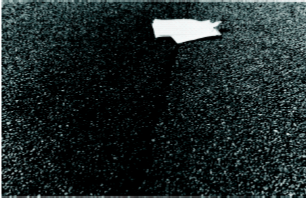
Resim 3.24. Yüksek hasar seviyesinde çatlak, Gözenekli asfalt tabakası [23]
