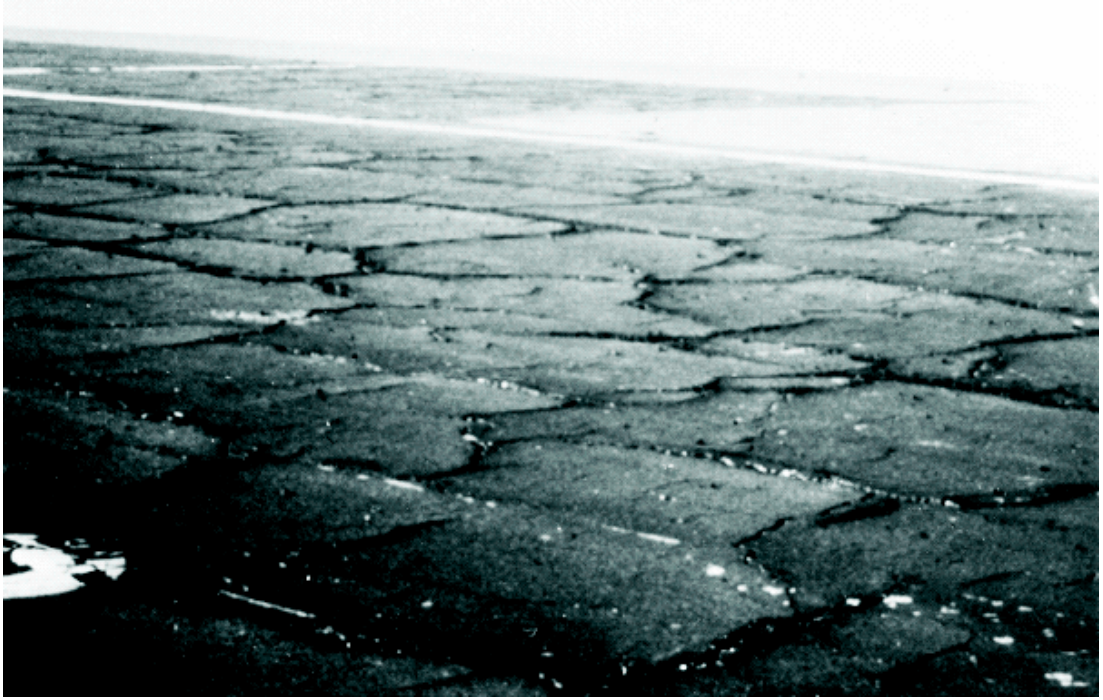
Resim 3.8. Yüksek hasar seviyesinde blok kırılması [20]
