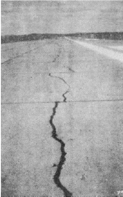
Resim 2.10. Düşük hasar seviyesinde doldurulmuş boyuna çatlak [20]
