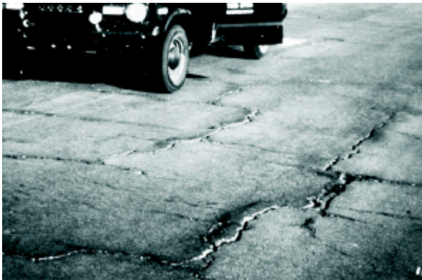
Resim 3.7. Yüksek hasar seviyesinde blok kırılması [23]
