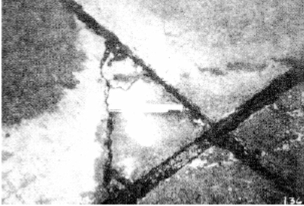
Resim 2.61. Orta hasar seviyesinde köşe kopması (Durum 1) [20]
