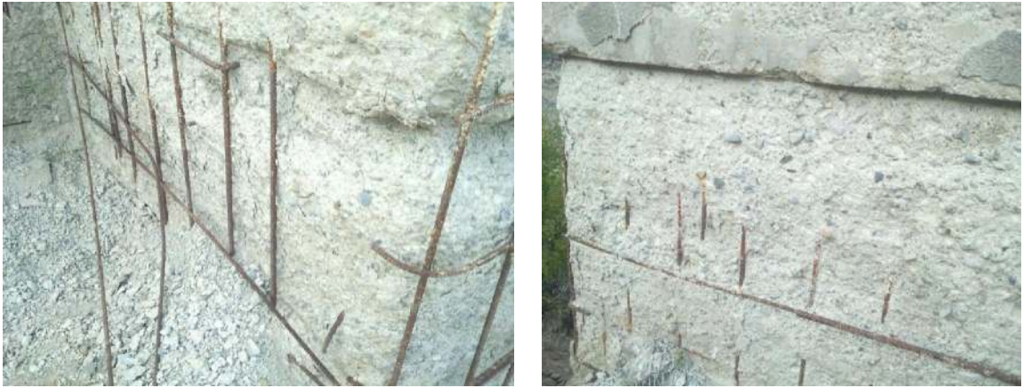
Şekil 1.6 Donma-çözülme etkisi ile bozulmuş beton elamanları
