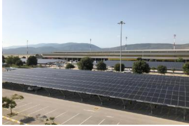
Şekil 2.14. Milas Bodrum Havaalanı güneş enerji panelleri (Solarist, 2023)
