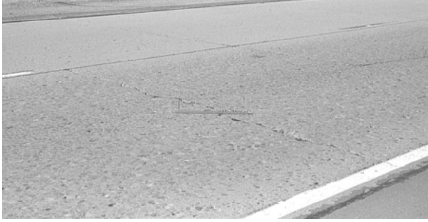
Şekil 22. Enine çatlama (Garg vd., 2004)
