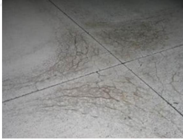
Şekil 23. Dayanım (D) çatlaması (Paul, 2014)
