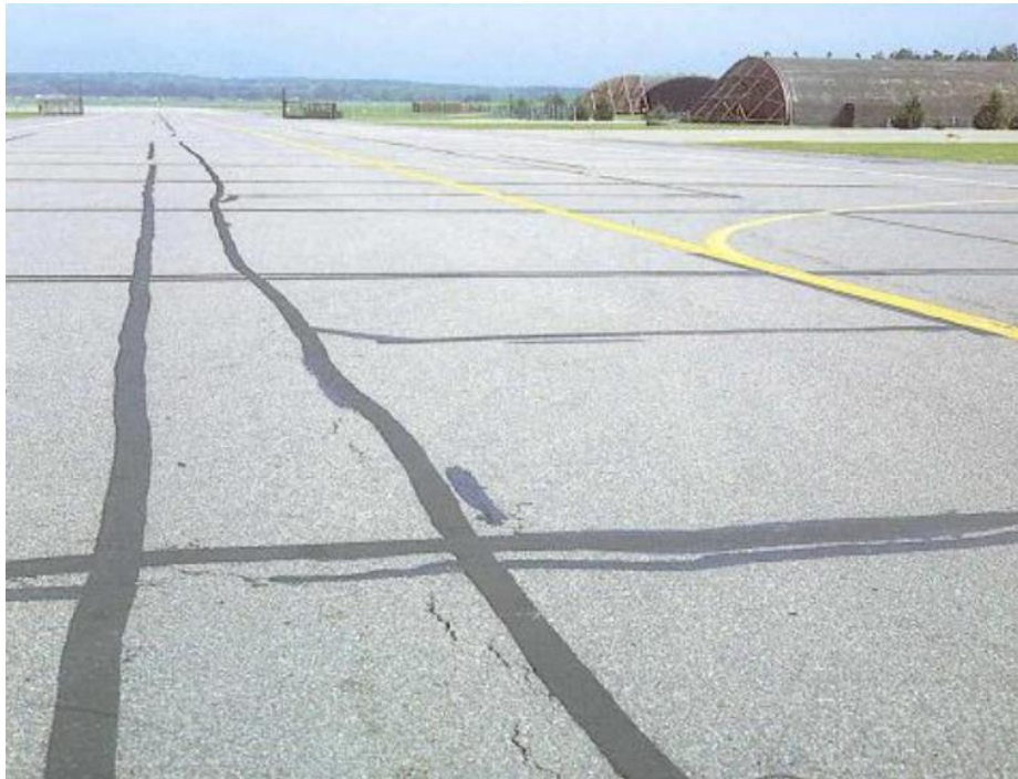
Şekil 16. Derz yansıma çatlağı (Defence Estates, 2005)
