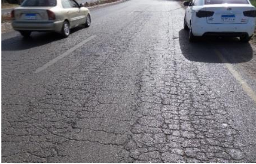
Şekil 13. Yorulma çatlağı (Abdalfattah vd. 2015)
