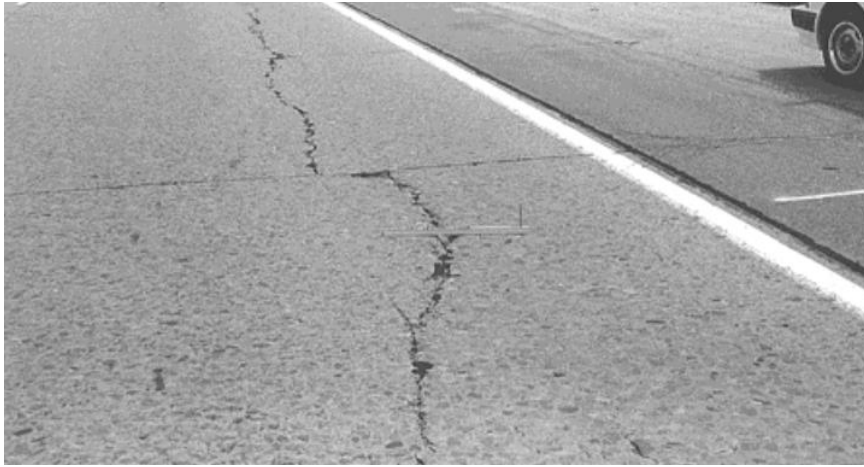
Şekil 21. Boyuna çatlama (Garg vd., 2004)
