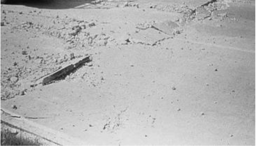
Şekil 19. Beton kaplamada patlama sorunu (Garg vd., 2004)
