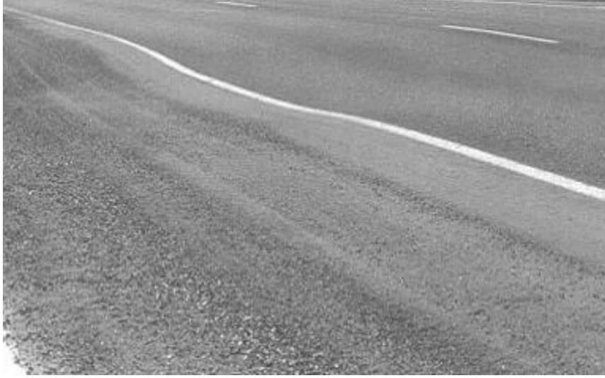
Şekil 15. Kaplamadaki çöküntü deformasyonu (Garg vd., 2004)
