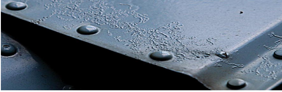
Şekil 1.13 : Tabaka altı korozyon örneği [9].
