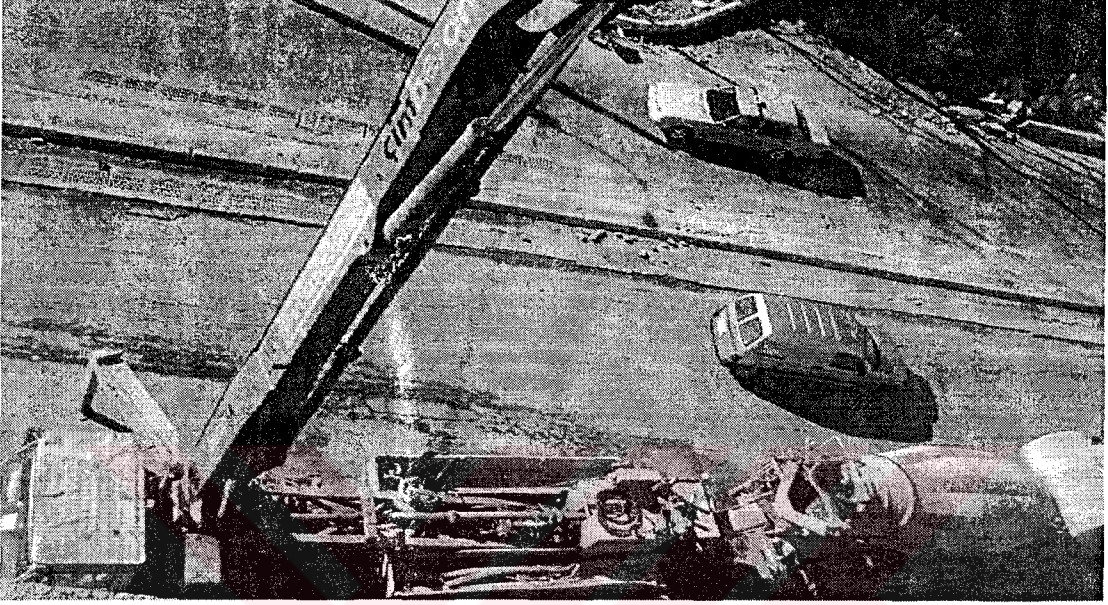
Şekil 5.14: Pompa ve Mikser Çalışması
