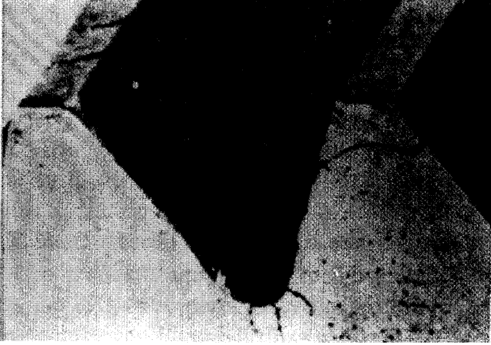
Şekil 2.35 Su verme sırasında oluşan çatlaklar
