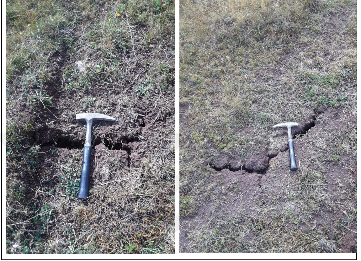
Şekil 12. İnceleme alanı AÇ-1 nolu araştırma çukuru civarında zeminde gözlemlenen açılmalar
