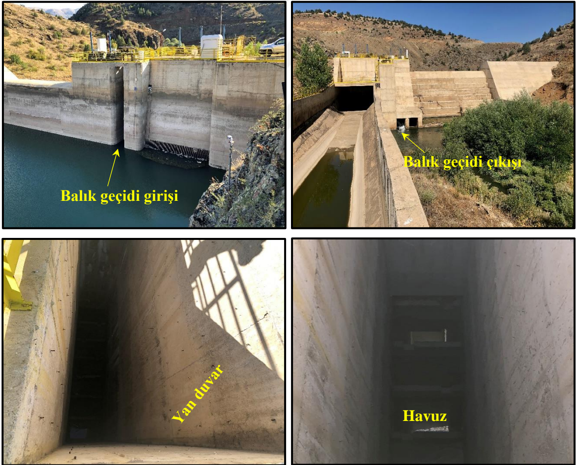
Şekil 3.3. Köprübaşı regülatörünün balık geçidi
