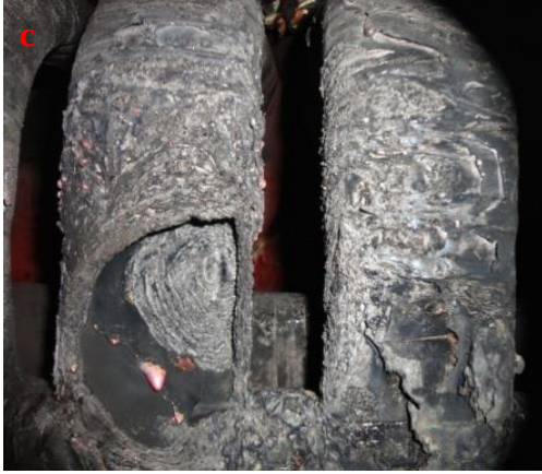
Resim 4.1.c. Bara izolasyon arızası
