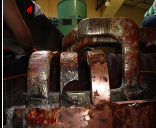
Resim 4.1.d. Bara izolasyon arızası
