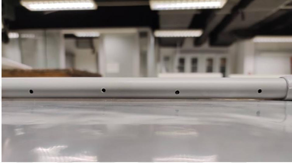
Şekil 5.12: Hava tahliyesi için boru sisteminde açılan delikler.
