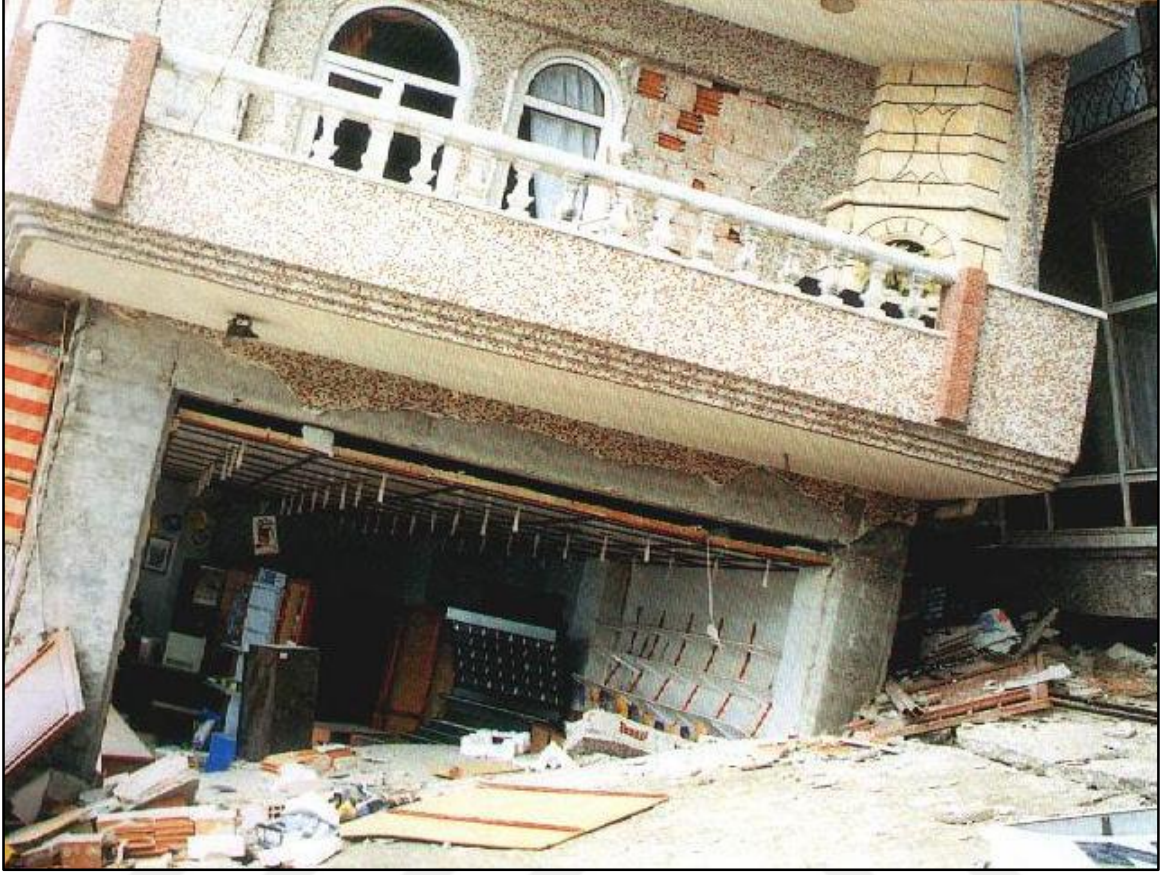
Şekil 3.13. Sıvılaşma sonucu yapılarda gözlenen oturmalar (Şahinalp, 2009).
