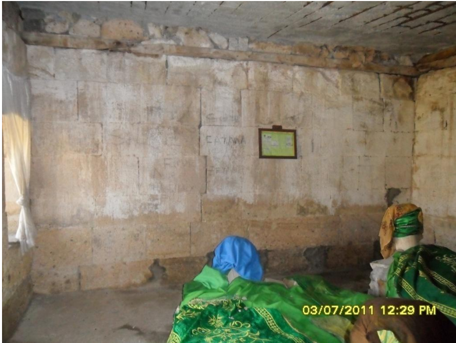
Resim 3.23. Türbe DV2 duvarı, Temmuz 2011 [12]
