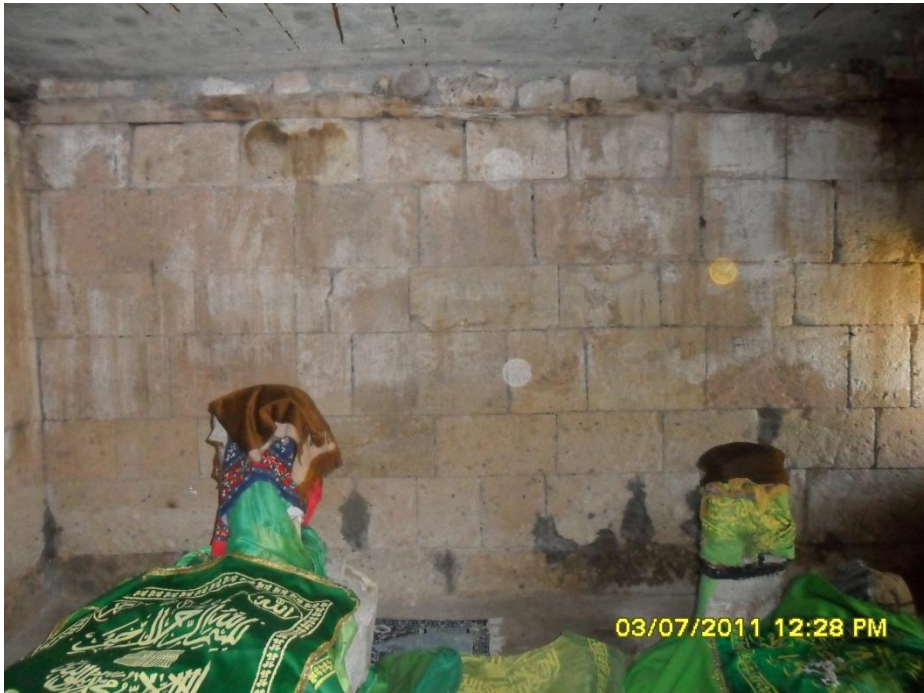
Resim 3.25. Türbe DV4 duvarı, Temmuz 2010 [12]
