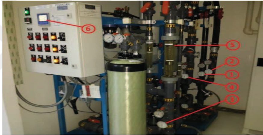
Şekil 4.1. Soğutma suyu göstergeleri
