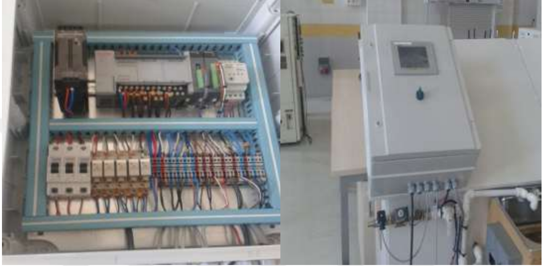
Şekil 4.12. Kontrol panosu ve panonun içindeki donanımlar
