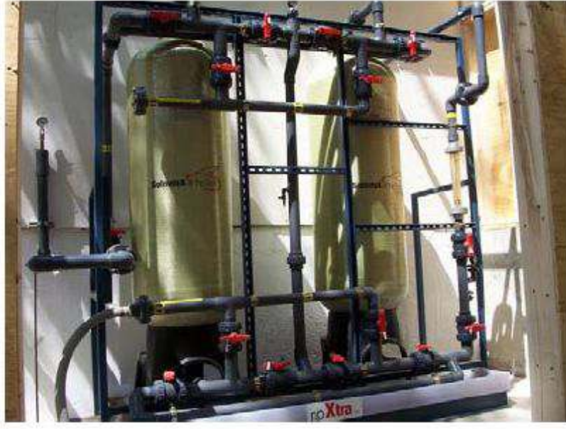
Şekil 2.7. PES arsenik giderim sistemi (Turkey Hills apartmanları)
