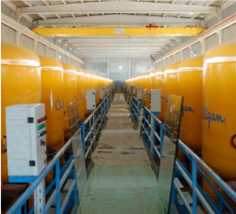
Şekil 2.1. İzmir arsenik arıtma tesisinden bir görünüm
