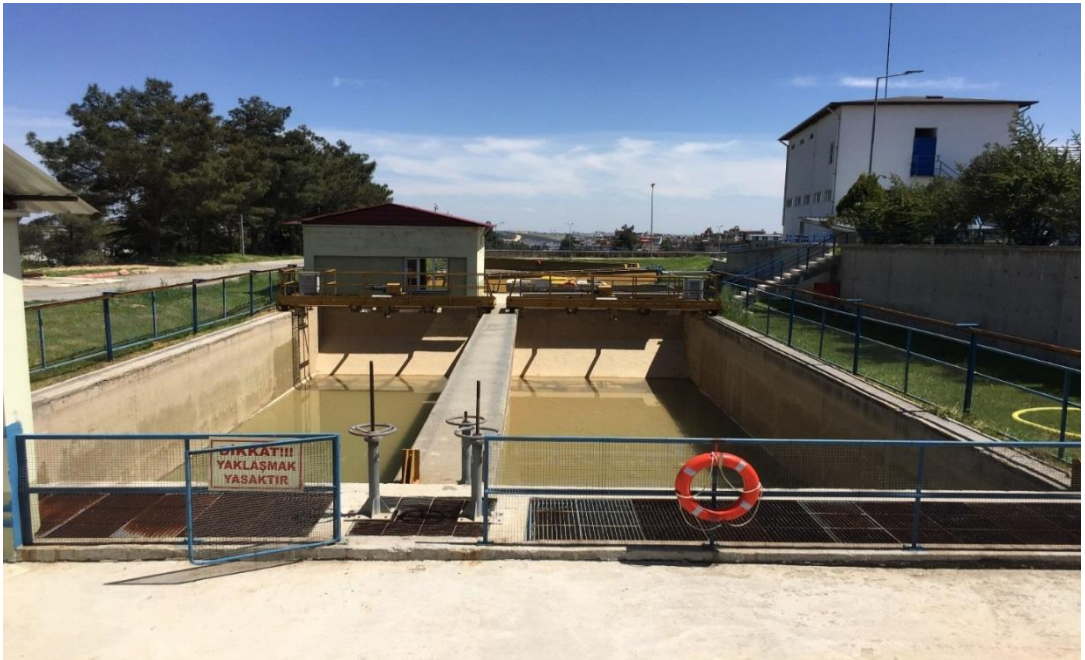
Şekil 3.12: Geri Yıkama Ünitesi - 2
