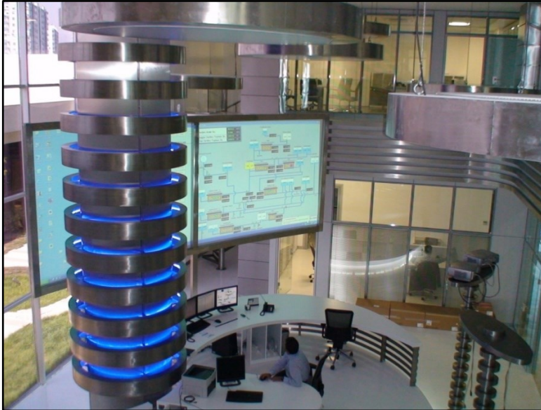
Şekil 3.3. ASAT SCADA merkezi
