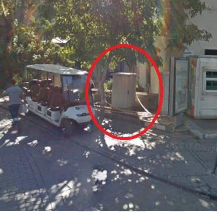
Şekil 3.15. Kaleiçi SCADA istasyonu
