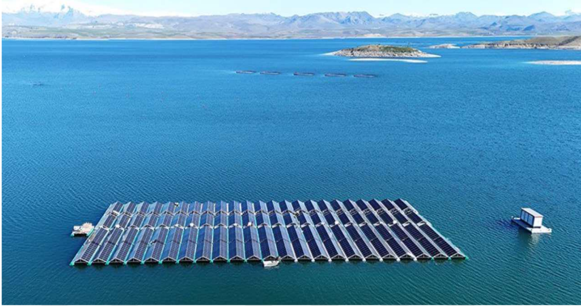
Resim 2.4. Keban barajı üzerine kurulan 1 MW YGES
