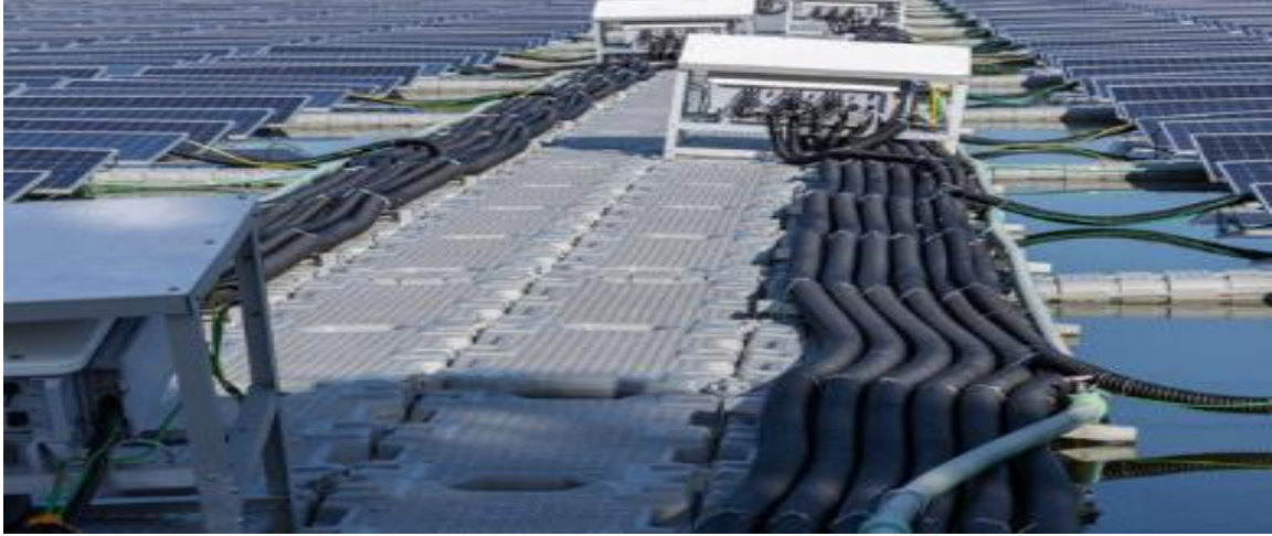
Resim 2.13. YGES kablolama sistemi
