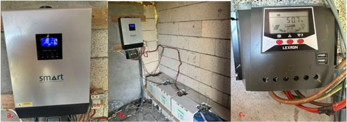
Resim 6.2. Kurulumu yapılan sistemin ekipmanları
