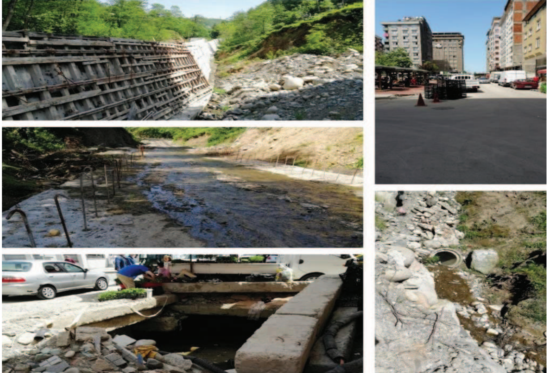
Fotoğraf 19: Paşakuyu Deresi Üzerindeki Yapılaşma ve Tersip Benti
