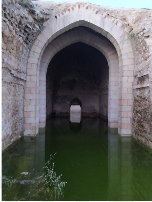
Şekil 4.69. Beton Bariyerlerden Su Sızması Sonucu Sular Altında Kalan Küçük Saray.
