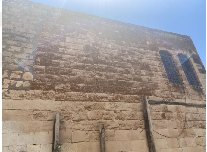
Şekil 4.34. 4 Numaralı Yapıda Liken Oluşumu.
