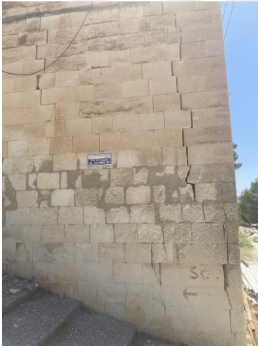
Şekil 4.33. 4 Numaralı Yapıda Yapısal Çatlak.
