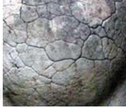
Şekil 3.2. Çatlaklar ağı Kaynak: ICOMOS, 2008.
