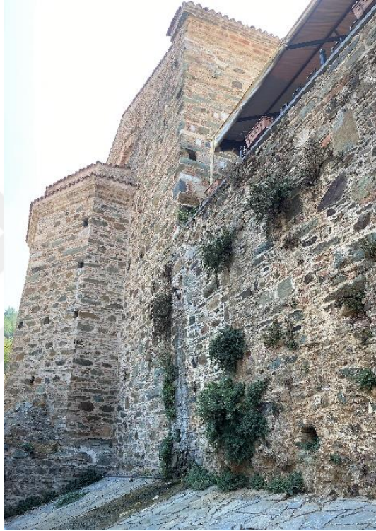
Şekil 3.14. Aziz John Baptist Kilisesi Dış Cephe Duvarında Bitkilenme
