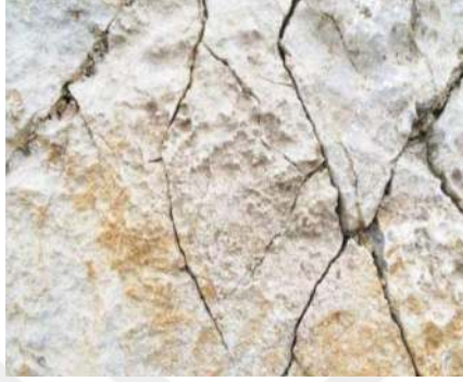
Şekil 3.1. Yıldız Şeklinde Çatlak Oluşumu Kaynak: Hasbay, 2017.
