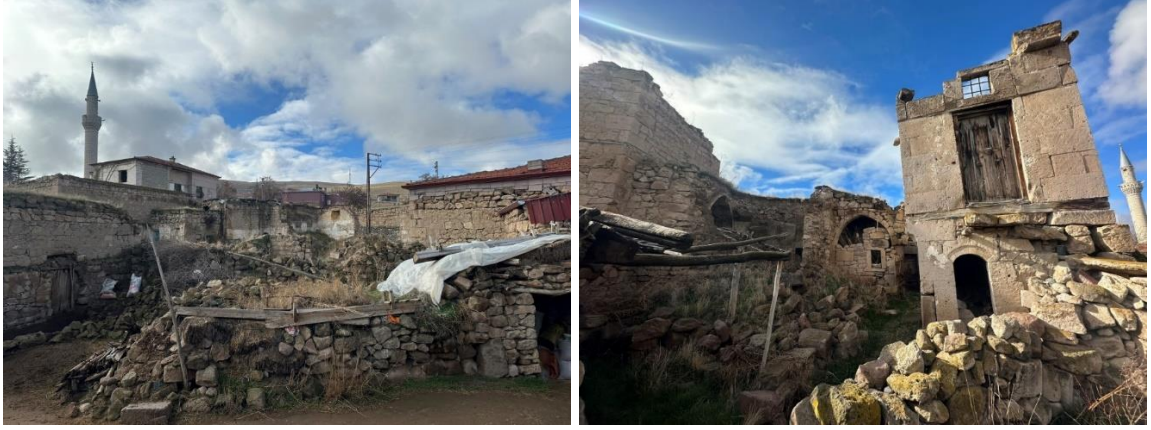
Şekil 5.63. Uluagaç köyünde yıkılmış durumdaki yapılar
