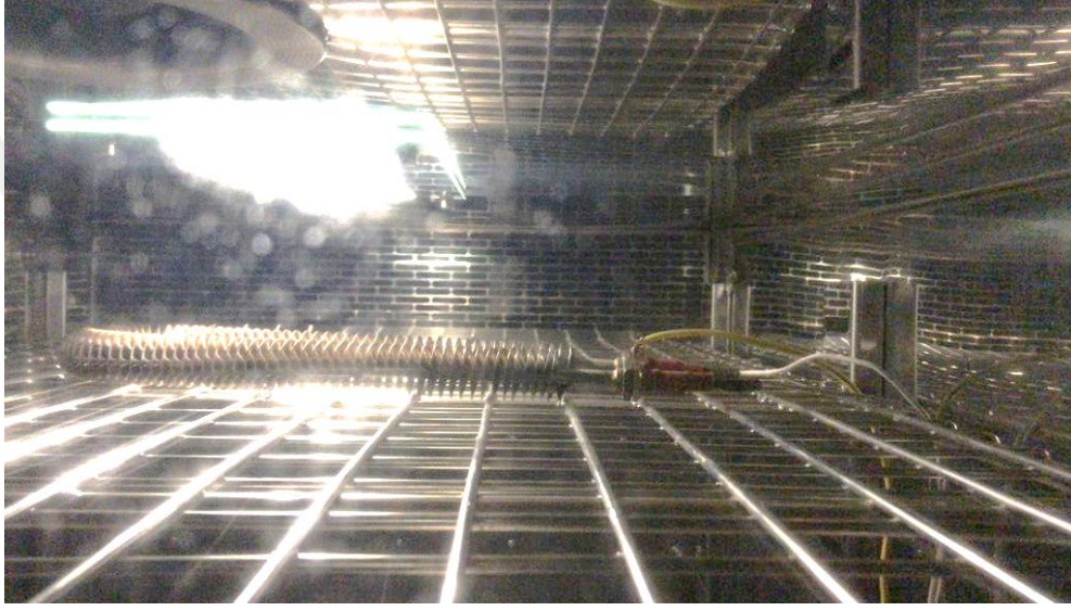
Fotoğraf 4-3. Isıl Yük Simülasyonu için Odanın İçine Yerleştirilen Rezistans
