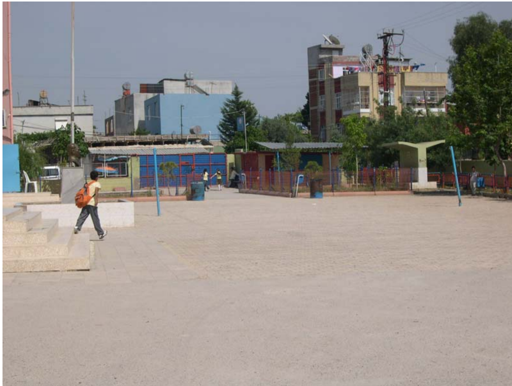
Şekil 3.15. 24 Kasım İlköğretim Okulu Beton Zemin İle Kaplı File Demirleri Bozulmuş Voleybol Sahası
