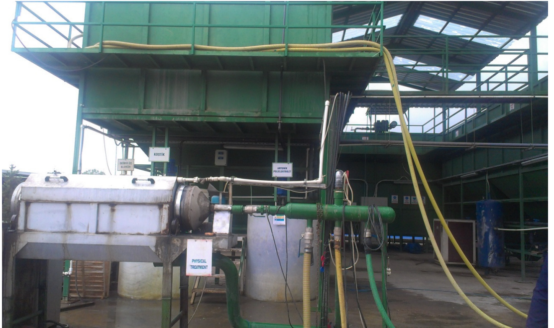
Şekil 3.2 Kot boyama atık sularının arıtıldığı atık su tesisi
