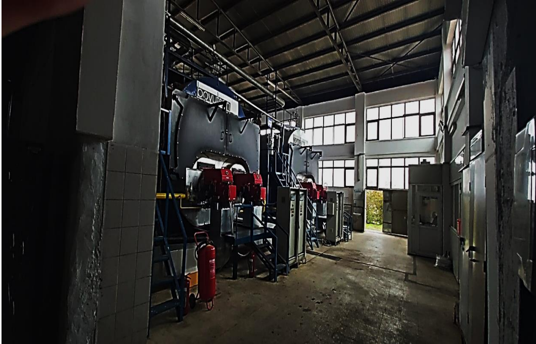
Şekil 3.2: İnönü Üniversitesi Merkezi Isı Santralindeki kazanlar.
