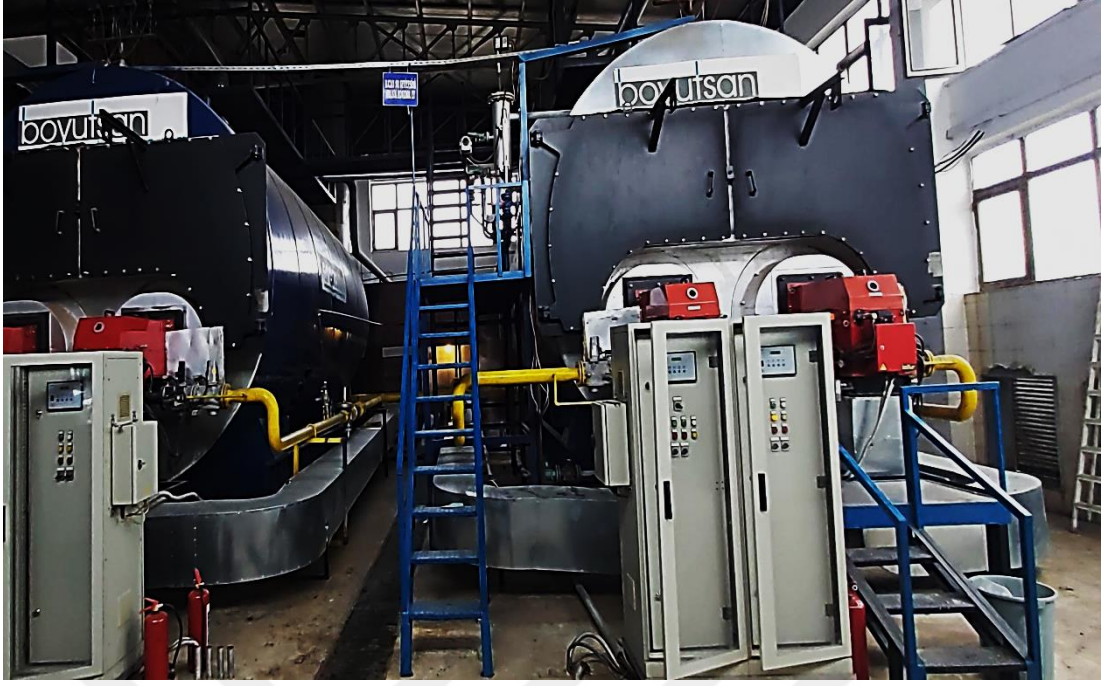
Şekil 3.3: İnönü Üniversitesi Merkezi Isı Santralindeki kazanlar.
