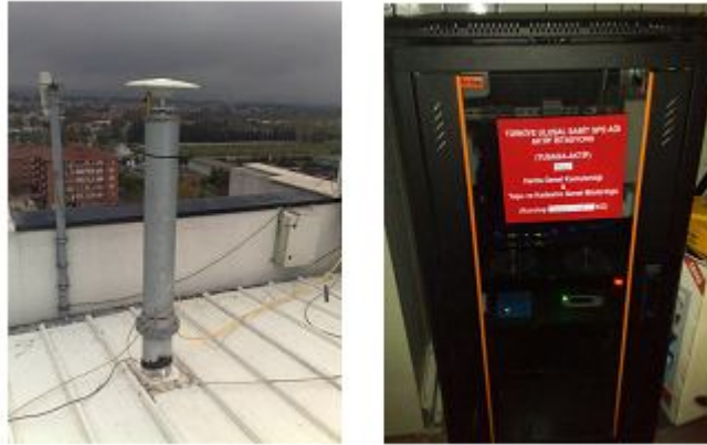
Şekil 8.17: CORS TR Kontrol Merkezi
