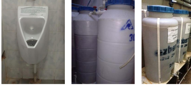
Şekil 6.1 : İdrar ayıran susuz pisuvar ve depolama tankları.
