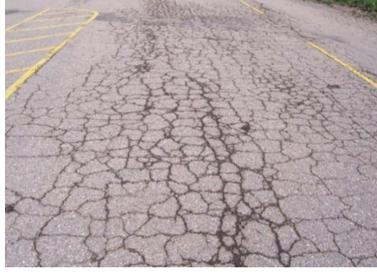
Resim 2.3 Yüksek şiddetli timsah sırtı çatlak (Gürer 2014)
