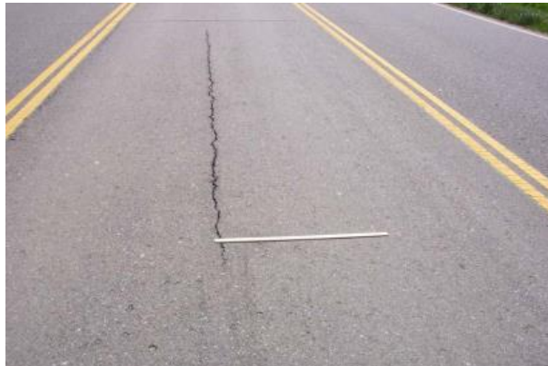
Resim 2.29 Orta şiddetli boyuna ve enine çatlak (Gürer 2014)
