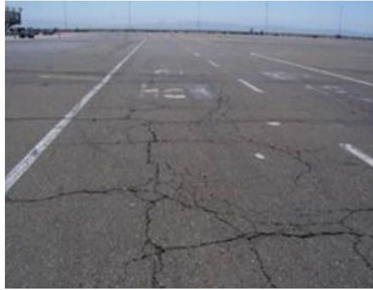
Resim 2.9 Yüksek şiddetli blok çatlak (Gürer 2014)
