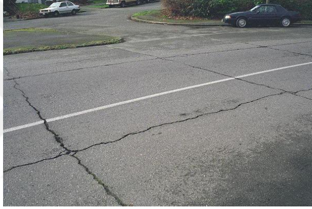
Resim 2.24 Yüksek şiddetli yansıma çatlağı (Gürer 2014)
