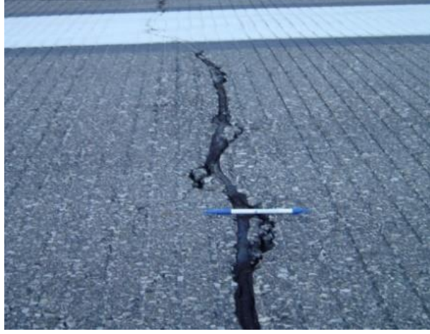
Resim 2.30 Yüksek şiddetli boyuna ve enine çatlak (Gürer 2014)
