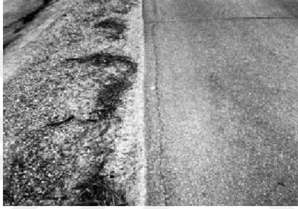
Resim 2.19 Düşük şiddetli kenar çatlağı (Gürer 2014)
