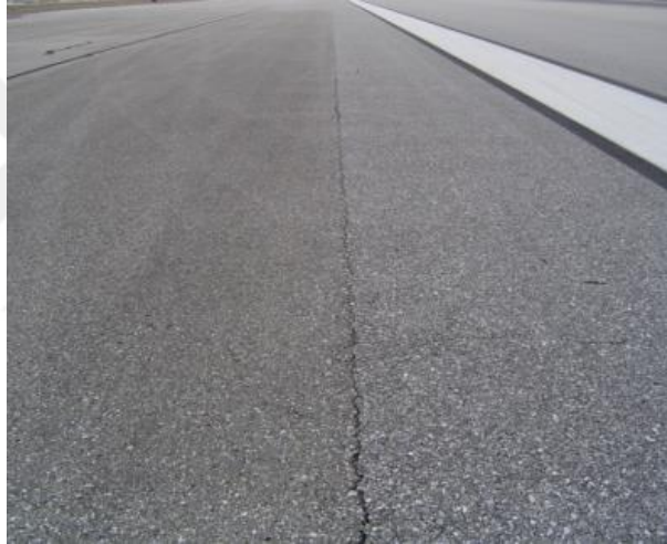
Resim 2.28 Düşük şiddetli boyuna ve enine çatlak (Gürer 2014)
