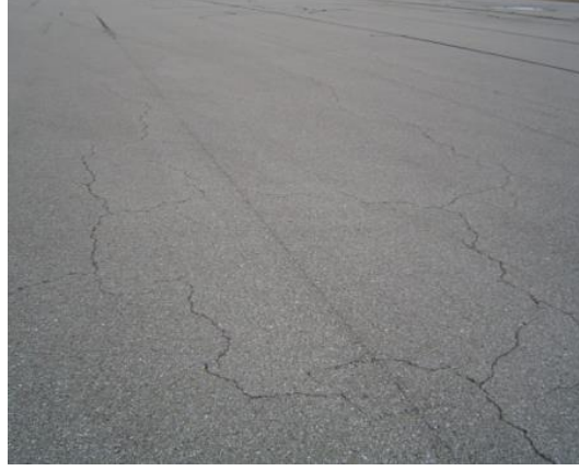
Resim 2.7 Düşük şiddetli blok çatlak (Gürer 2014)
