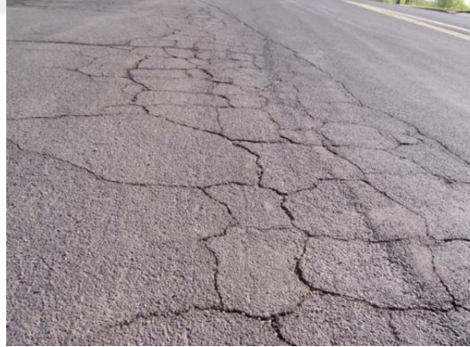
Resim 2.2 Orta şiddetli timsah sırtı çatlak (Gürer 2014)
