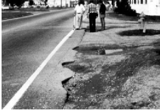
Resim 2.21 Yüksek şiddetli kenar çatlağı (Gürer 2014)
