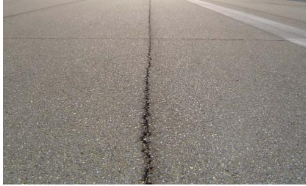
Resim 2.22 Düşük şiddetli yansıma çatlağı (Gürer 2014)
