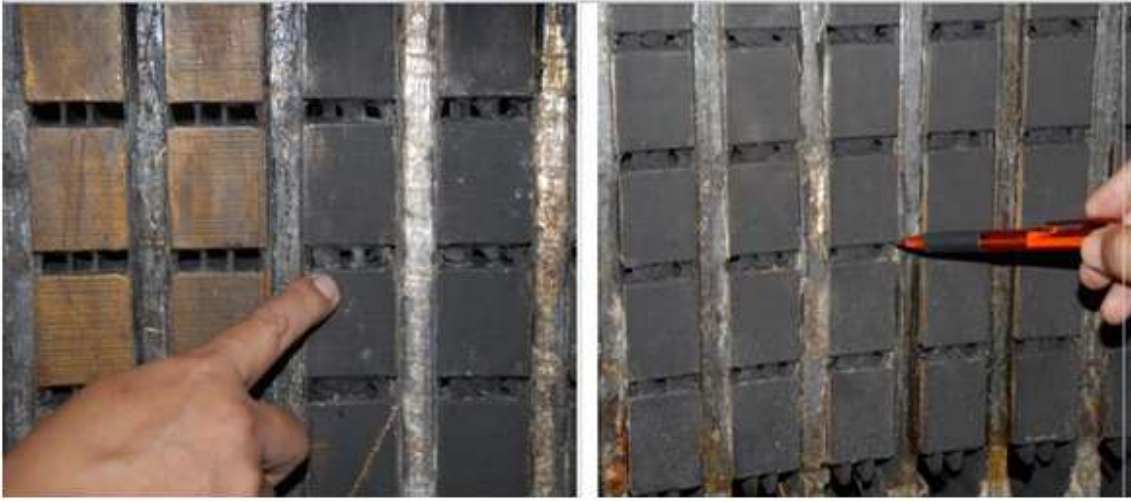
Şekil 32. Yağ ve kömür tozu kirliliği kaynaklı hava kanalları tıkanmış bir generatör (Nugroho, Widiastuti, & Ary, 2017)
