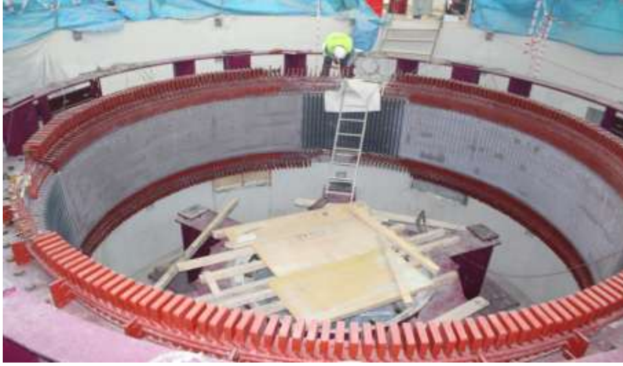
Şekil.12 Bağıştaş I HES senkron generatör stator sargıları
