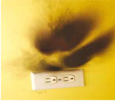
Resim 9.1. Elektrik tesisat kaynaklı yangın. (Kılıç, 2010a)
