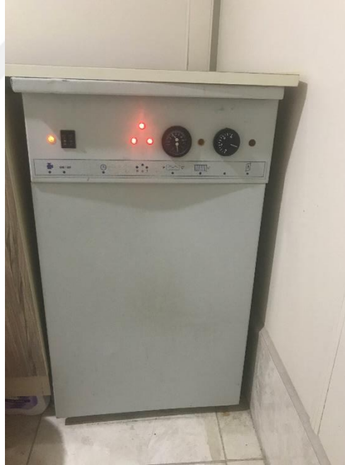
Şekil 6. Elektrikli ısıtma sistemi
