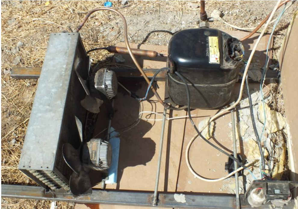
Şekil 2.6. Deney odasının soğutma sisteminin görünüşü
