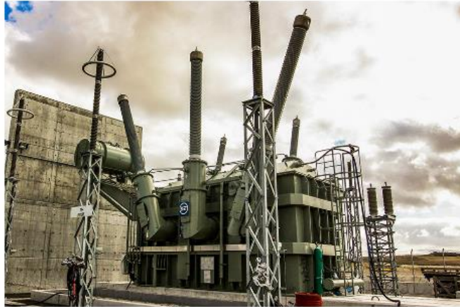
Şekil 25. Güç Trafosu (BEST Trafo, 2024)
