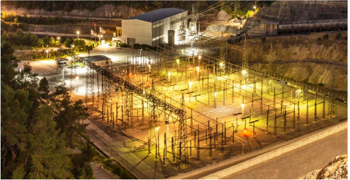
Şekil 26. Sanko Enerji Sanibey Barajı Şalt Sahası (Sanko Enerji, 2024)
