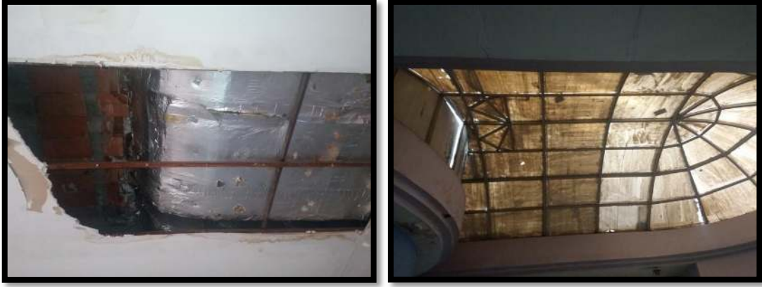
Şekil 4.24. Diyar Galeria AVM çatısı fiziksel bozulmalar
