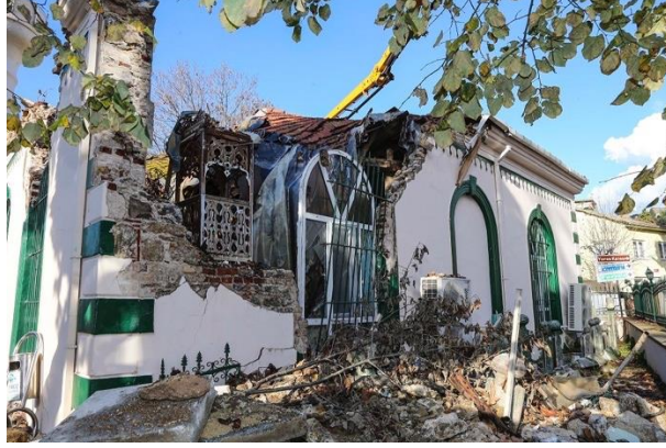
Şekil 132 Camiinin Çınarın Devrilmesinden Sonraki Durumu
