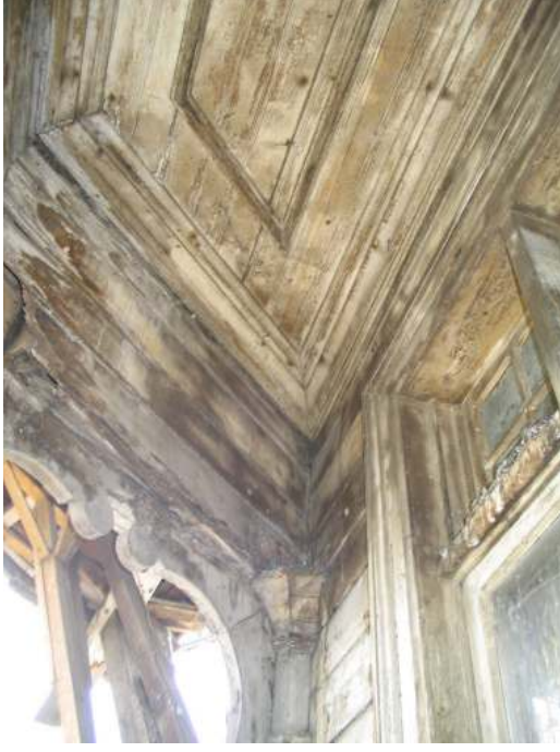
Resim 1.73. Balkondaki strüktürel problem
