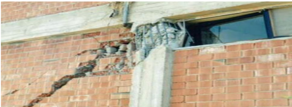
Resim 3.5. Hasar görmüş kısa kolon
