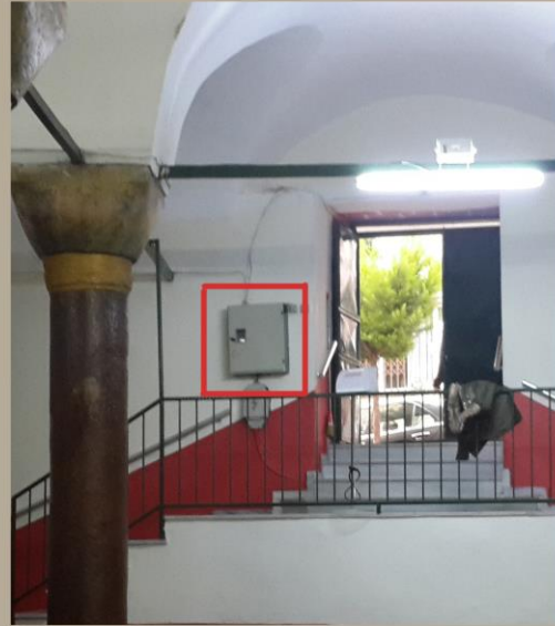
Şekil 4.52.C. Elektrik Panosu (Yıldırım Arşivi)
