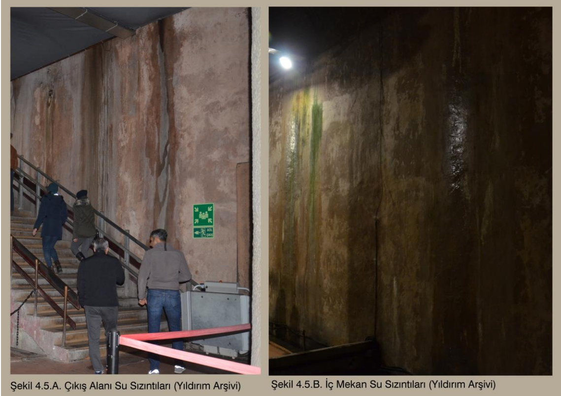
Şekil 4.5. Yerebatan Sarnıcı, Su Sızıntılarını Gösteren Duvar Bozulmaları
