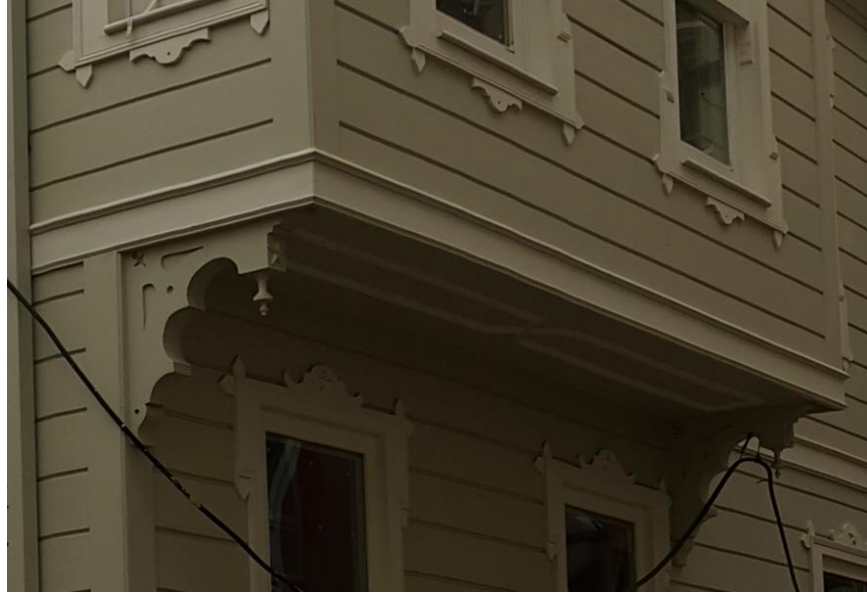
Fotoğraf.20. Konsol, Ada:230, Parsel:1 (Kaya, 2015)
