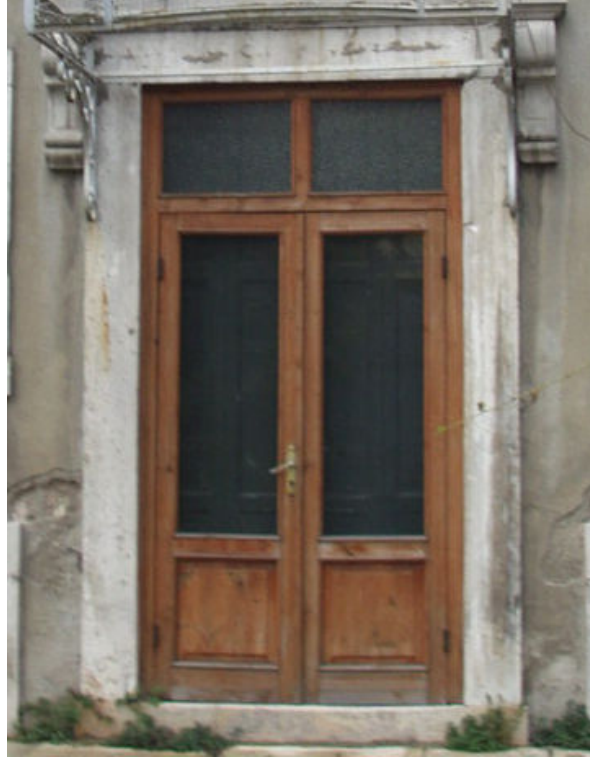
Şekil 6.84 Giriş kapısının önündeki muhdes ahşap kapı.
