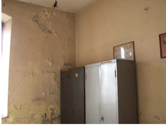
Şekil 6.25 Z02 mekanının rutubetten kabarmış duvar sıvaları.
