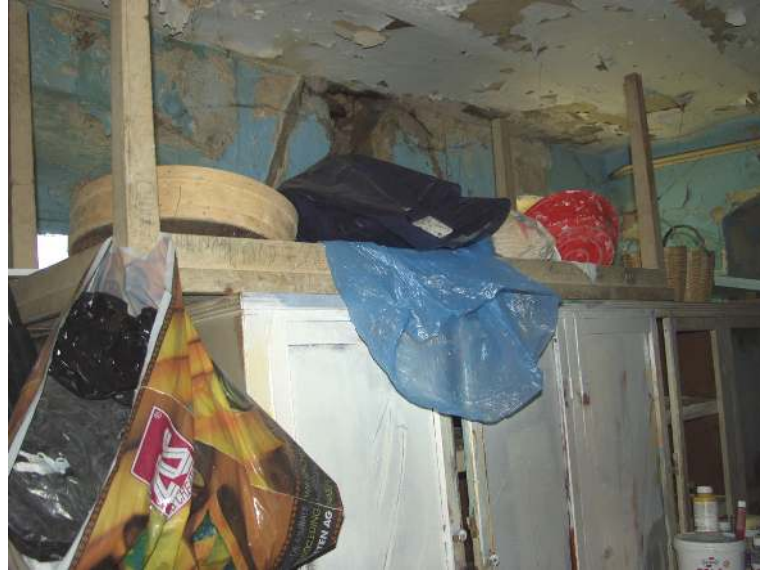
Şekil 6.9 B11 mutfak mekanı, baca izi.
