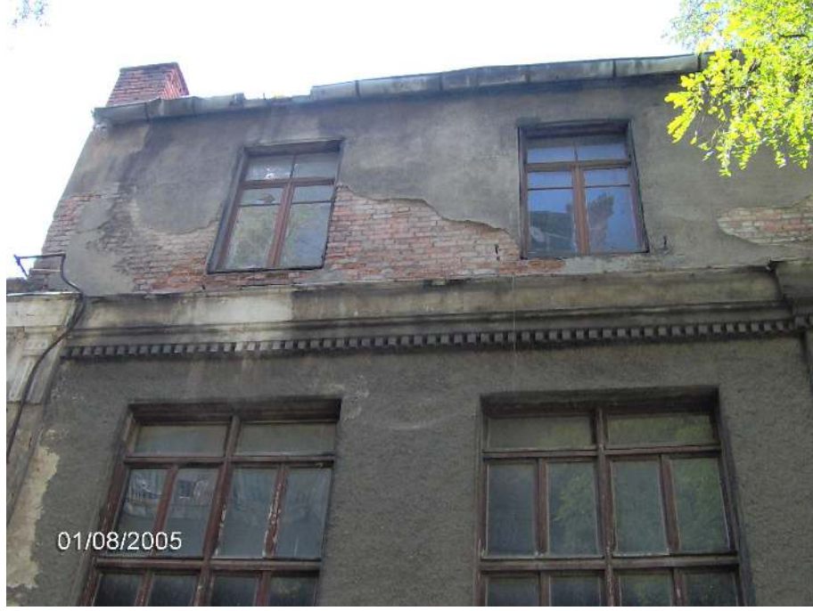
Şekil 4.12 Kuzeydoğu Cephesi, ek çimento sıva yapılan bölgeler.ç
