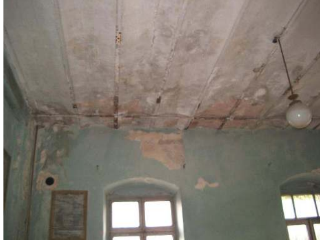
Şekil 6.53 101 sınıf mekânı voltalarının bugünkü durumu, paslanmış putreller.
