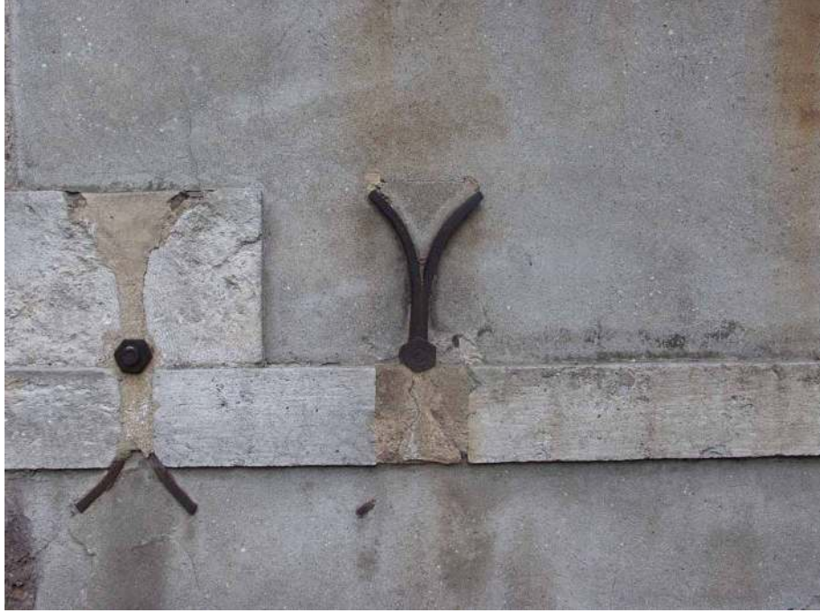
Şekil 6.92 Metal elemanlarda paslanma.
