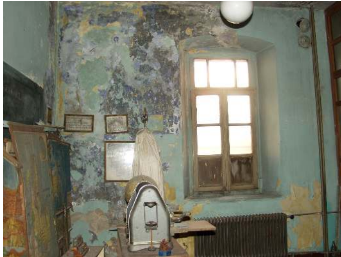
Şekil 6.36 Mekanın dış duvarlarında oluşmuş rutubet problemi.
