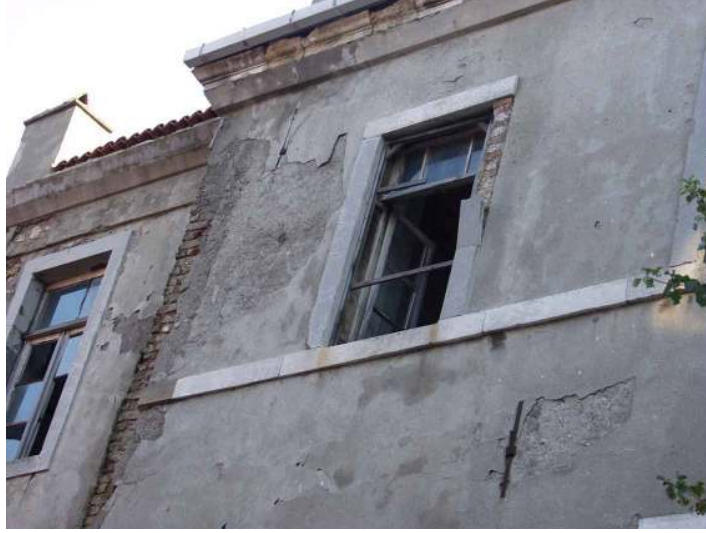
Şekil 6.111 Kırık söve, altı tuğla örgü.
