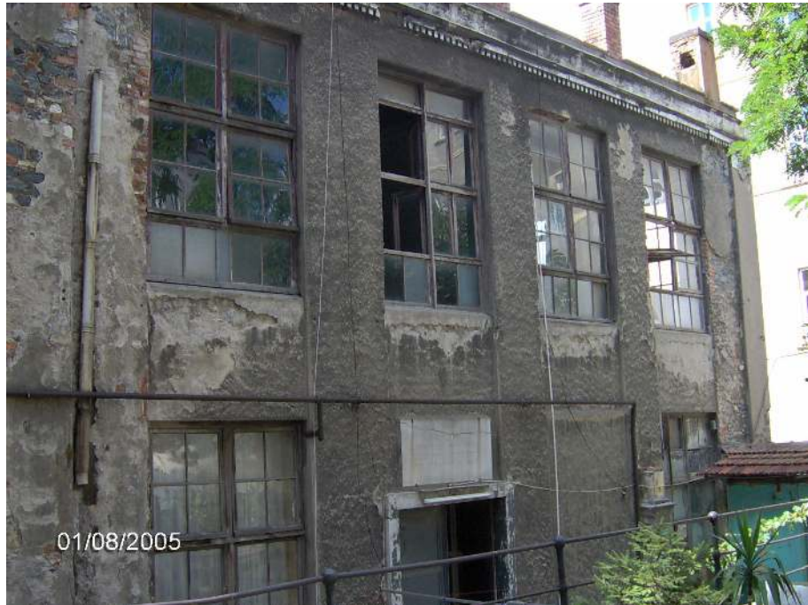
Şekil 4.11 Kuzeydoğu Cephesi'nde görülen sıva dökülmeleri ve bozulmalar
