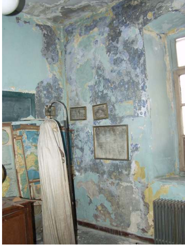
Şekil 6.37 Sıva şişmesi ve dökülmeler.
