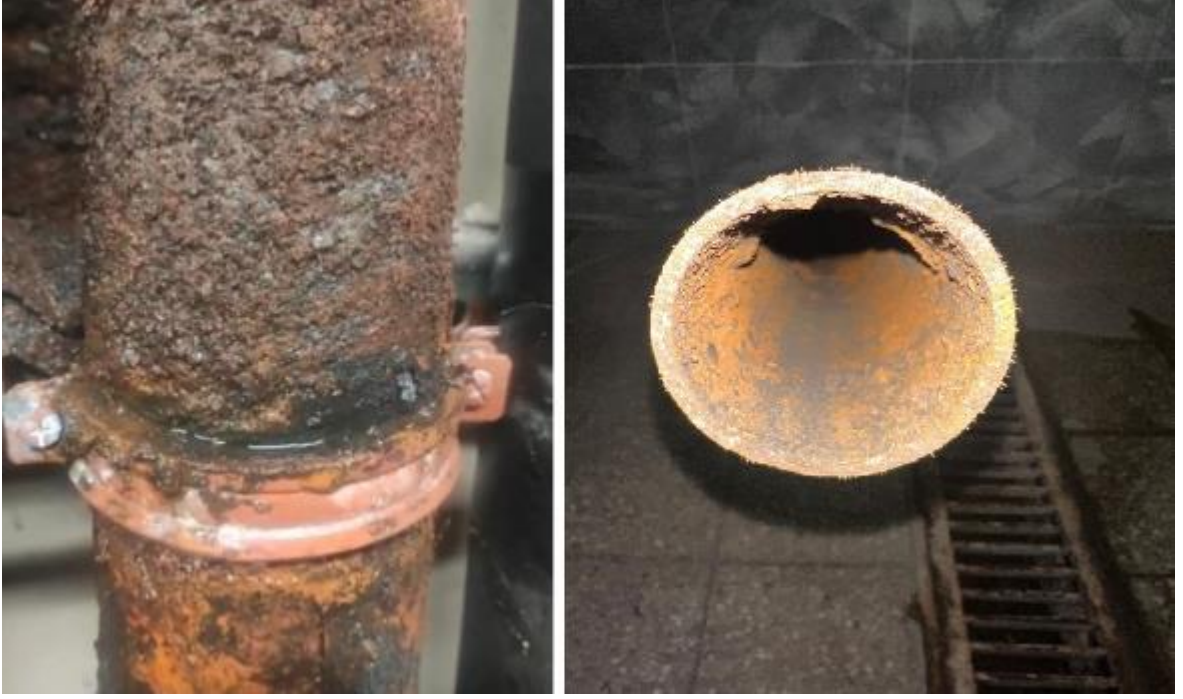
Şekil 12. Demir boru dış ve iç yüzeyinde oluşan korozyon
