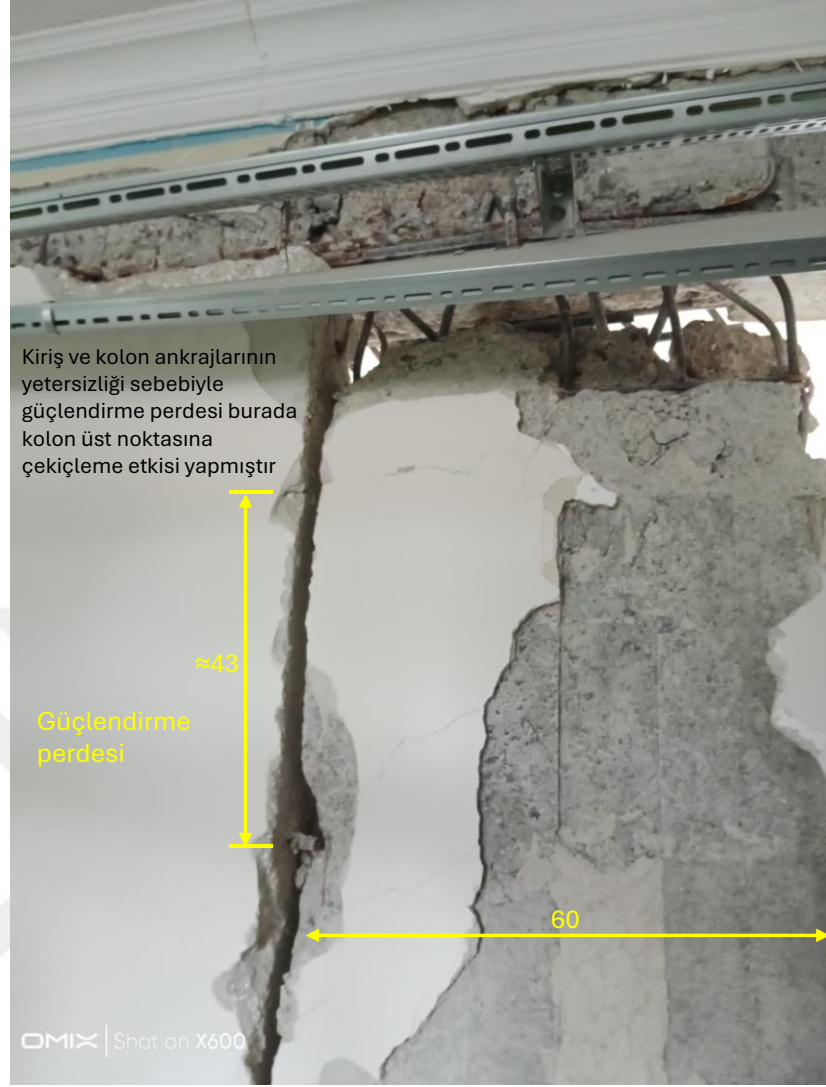
Şekil 34. Yapının güçlendirme perdesi ile mevcut kolon arasındaki ayrışma
