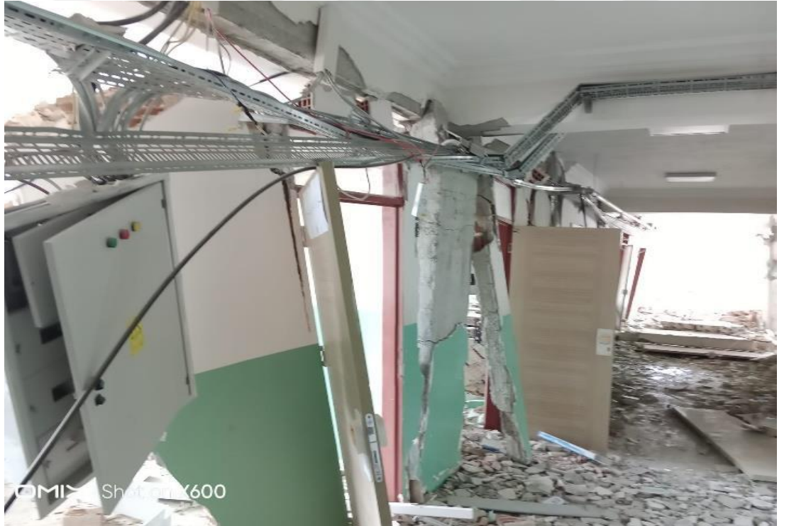
Şekil 30. Yapının deprem hasarı-4
