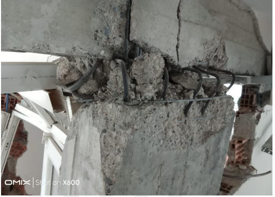
Şekil 27. Yapının deprem hasarı-1
