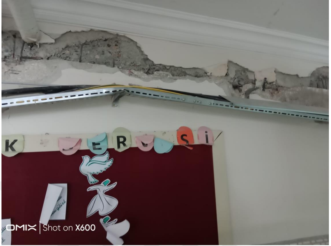
Şekil 35. Yapının güçlendirme perdesi ile mevcut kirişin arasındaki ayrışma
