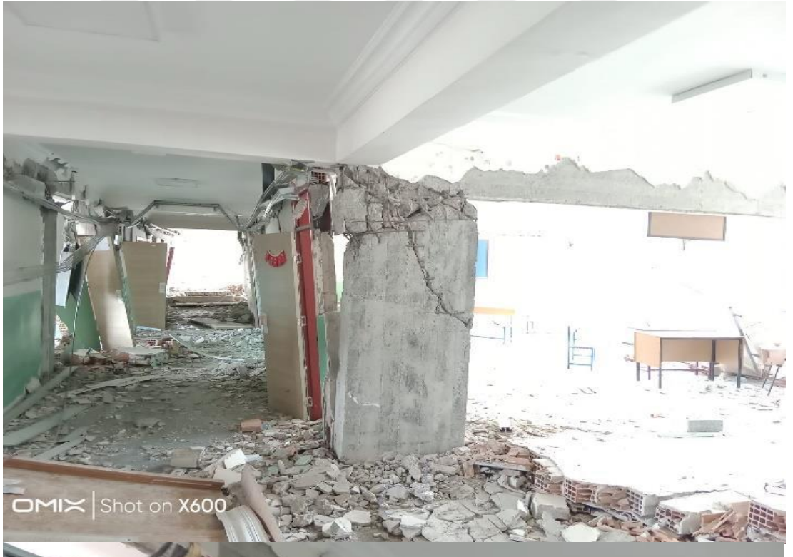
Şekil 28. Yapının deprem hasarı-2
