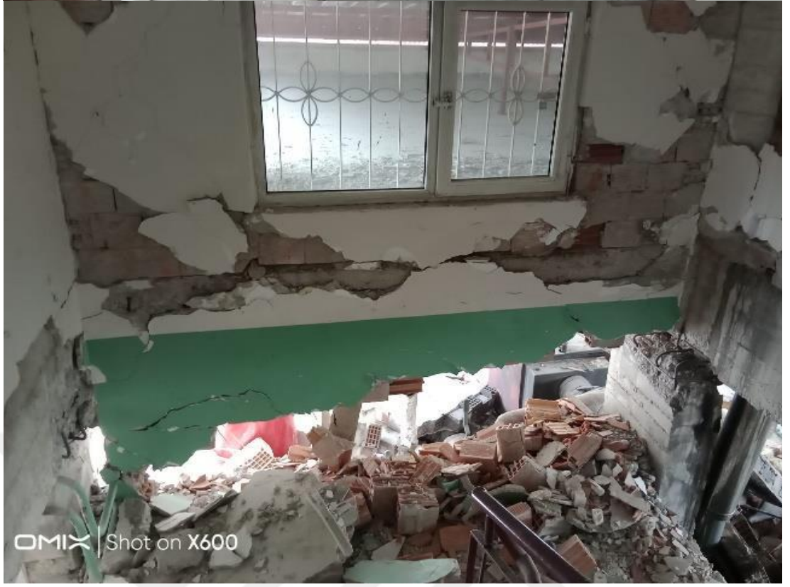
Şekil 29. Yapının deprem hasarı-3
