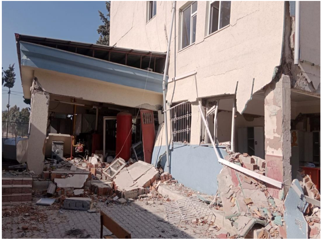
Şekil 32. Yapının deprem hasarı-6
