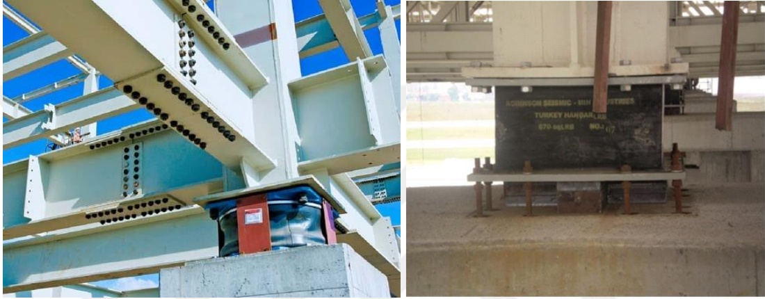
Şekil 10. Sabiha Gökçen Havalimanı'nda kullanılan sismik izolatörler
