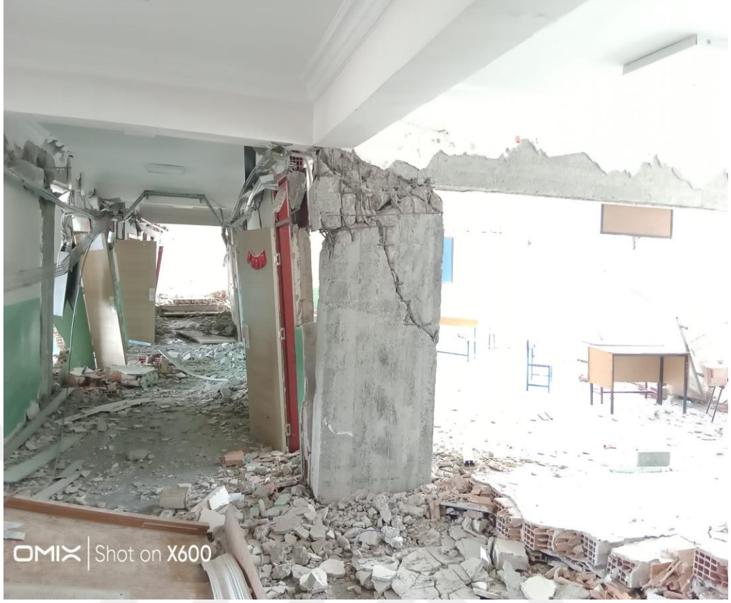
Şekil 31. Yapının deprem hasarı-5
