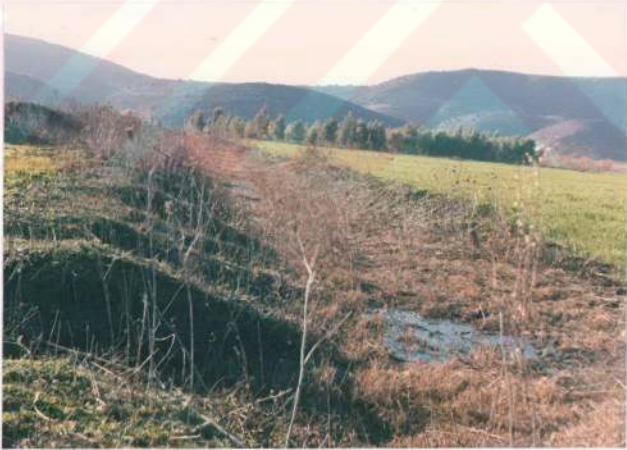
Resim 4.1. Kesiksuyu Sulaması D1-4 Yüzey Drenaj Kanalında Rüsubat Sorunu
